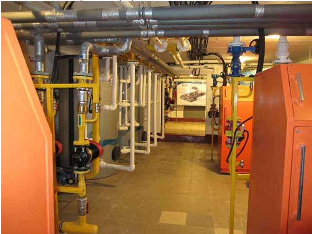
Рис. 2. Тепловой пункт с тепловыми насосами.
