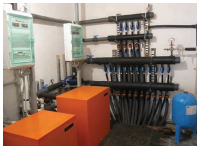
Тепловой пункт административного здания
